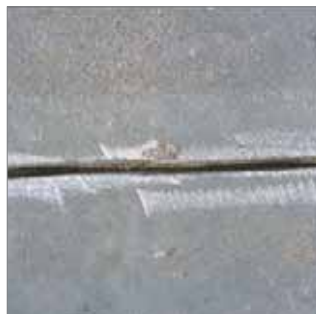
Estado de la junta: seca, sana, limpia y exenta de partículas sueltas.
